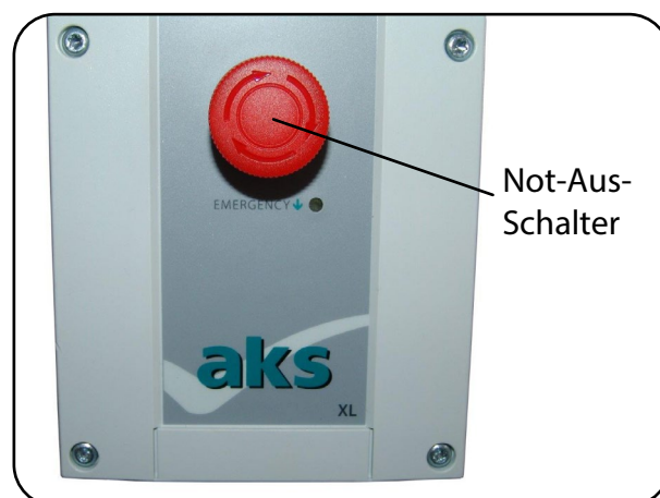
Abb. 8.5.01 – Steuereinheit mit Not-Aus-Schalter
